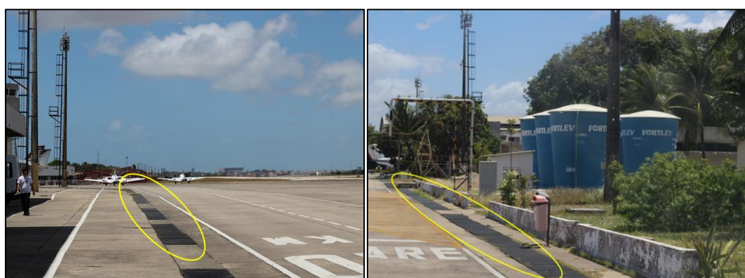
Figura 40: Grelhas de drenagem do pátio de aviação geral
