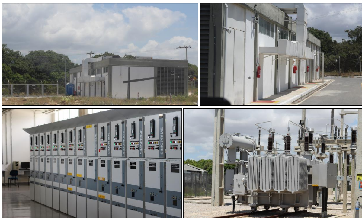
Figura 43: Subestação primária do aeroporto
