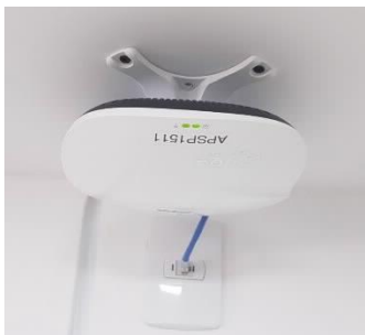
Ponto de Acesso (WAP)
