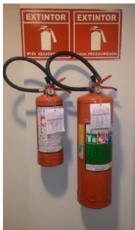
Extintores de Incêndio
