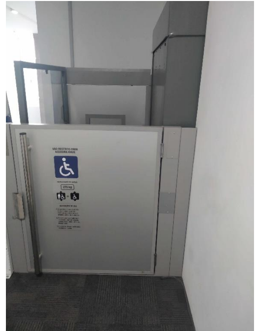
Plataforma elevatória de acessibilidade mezanino do térreo
