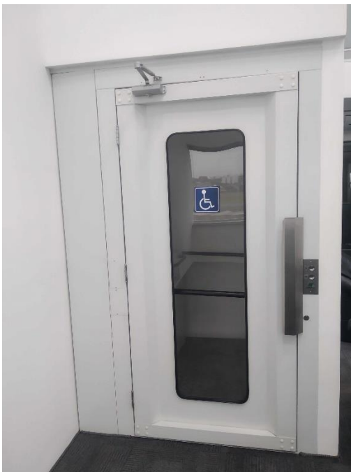
Plataforma elevatória de acessibilidade 9º andar
