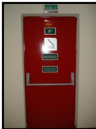
Foto 9: Porta da saída de emergência
