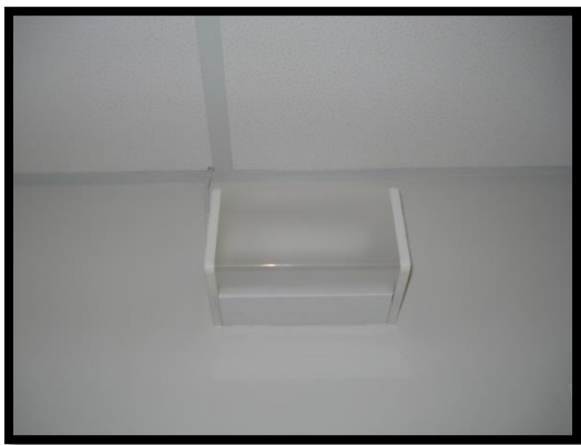
Foto 10: Luminária de emergência
