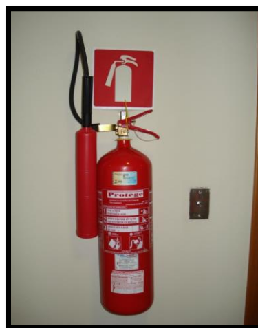
Foto 5: Extintor de Incêndio
