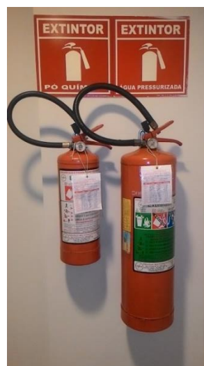
Foto 04: Extintor de Incêndio
