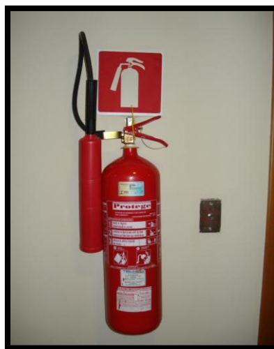
Foto 5 – Extintor de incêndio
