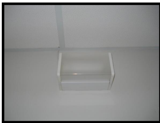
Foto 10 – Luminária de emergência
